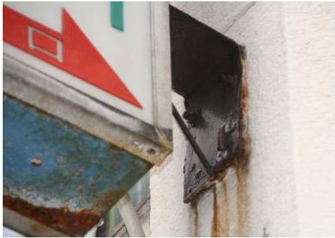
支持部分に著しい腐食が発生している (出典：特殊建築物等定期調査業務基準)
