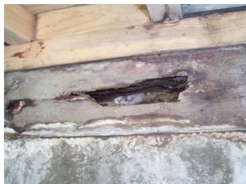
土台に蟻害が発生している (出典：特殊建築物等定期調査業務基準)
