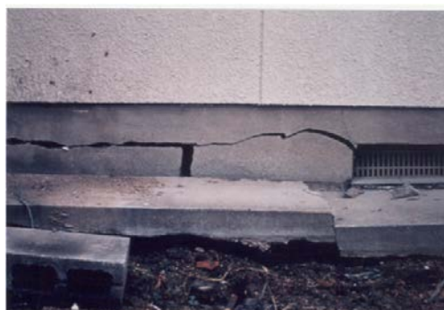
基礎が大きく破損している (出典：応急危険度判定マニュアル)
