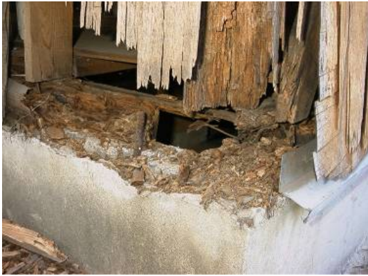
蟻害が発生し欠損している
