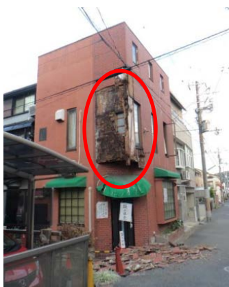
外壁が破損している
