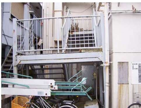
屋外階段が傾斜している (出典：特殊建築物等定期調査業務基準)
