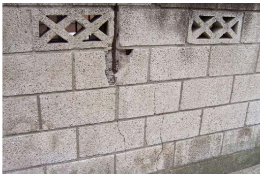
塀に大きなひび割れが生じている (出典：特殊建築物等定期調査業務基準)
