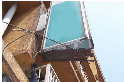
底板に腐食が発生している (出典：特殊建築物等定期調査業務基準)
