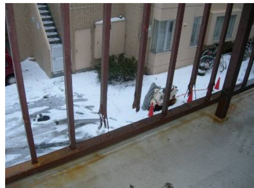
バルコニーの手すりが腐食している (出典：特殊建築物等定期調査業務基準)
