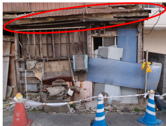
軒に不陸、剥離が生じている
