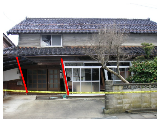
1階部分が傾斜している
