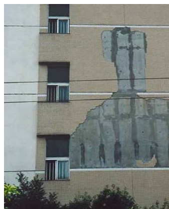
外壁に脱落が生じている
