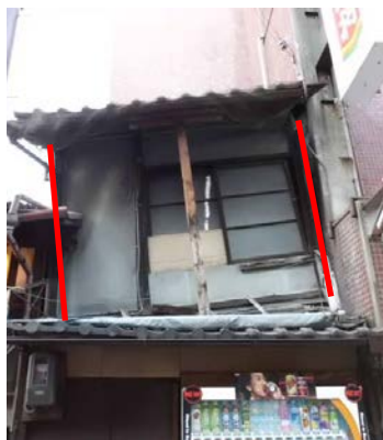
2階部分が沈み込み全体的に傾斜している
