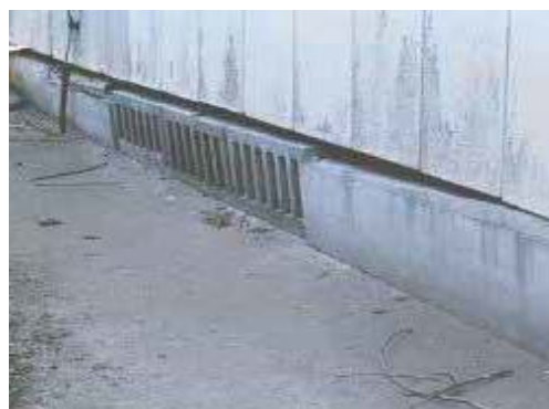
基礎が沈下し破損している (出典：特殊建築物等定期調査業務基準)
